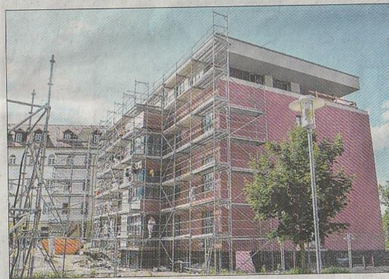
Der neue Anbau am Haus Mechthild im Burghof soll noch in diesem Herbst fertig werden. Foto: Jan Iven
